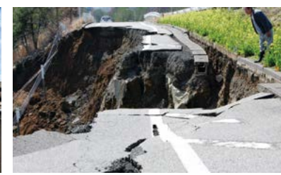
▲崩落した道路
