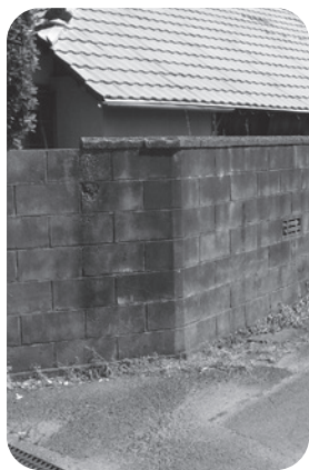
ひび割れが多く危険なブロック塀
